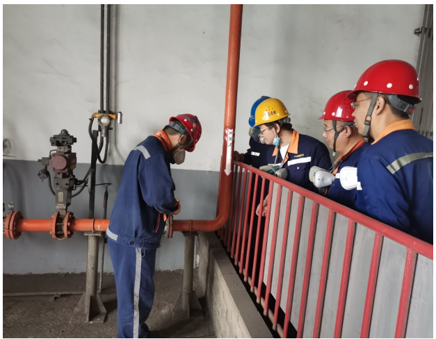
现场排查职业病防护设施的安全隐患
